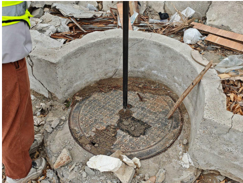
项目内污水检修井
