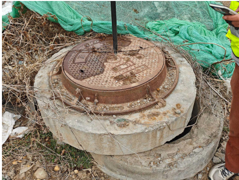
项目内上水检修井
